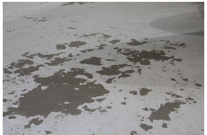
Malingen på store deler av gulvet er i dårlig forfatning
