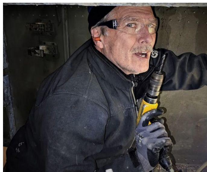
Bjørn Magnussen i gang med å bore ut nagler inne i det trange rommet innenfor vingefestene
